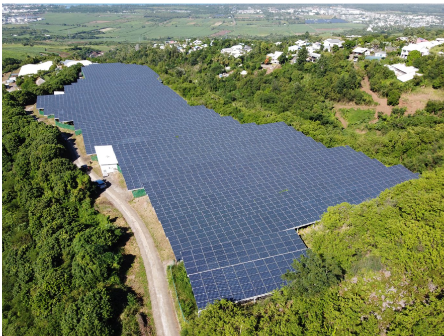
Centrale agrivoltaïque du Domaine de Bellevue, 2.5MWc
